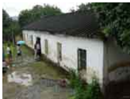
触ただけで壁が崩れる長屋B
